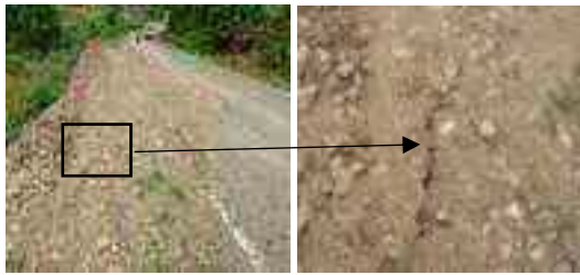
Gambar 8 Kenampakan retakan di bahu jalan Desa Popalo Kec. Anggrek
