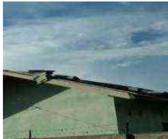
Gambar 7. Kondisi Atap Rumah yang Terlepas Akibat Angin (Sumber : Dokumentasi Penelitian, 2018)
